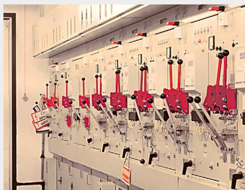
Рис. 10.2. Внешний вид смонтированного распредустройства
