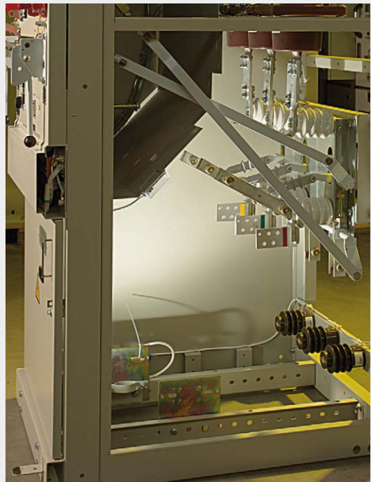
Рис. 9.1. Камера с выключателем. Зона высоковольтных присоединений
